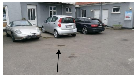
Billede nr. 8: Regnvandsrist
