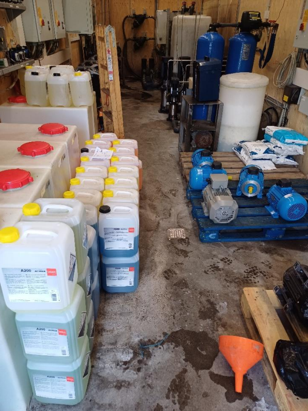
Oplag af kemikalier i teknikrum med gulv afløb
