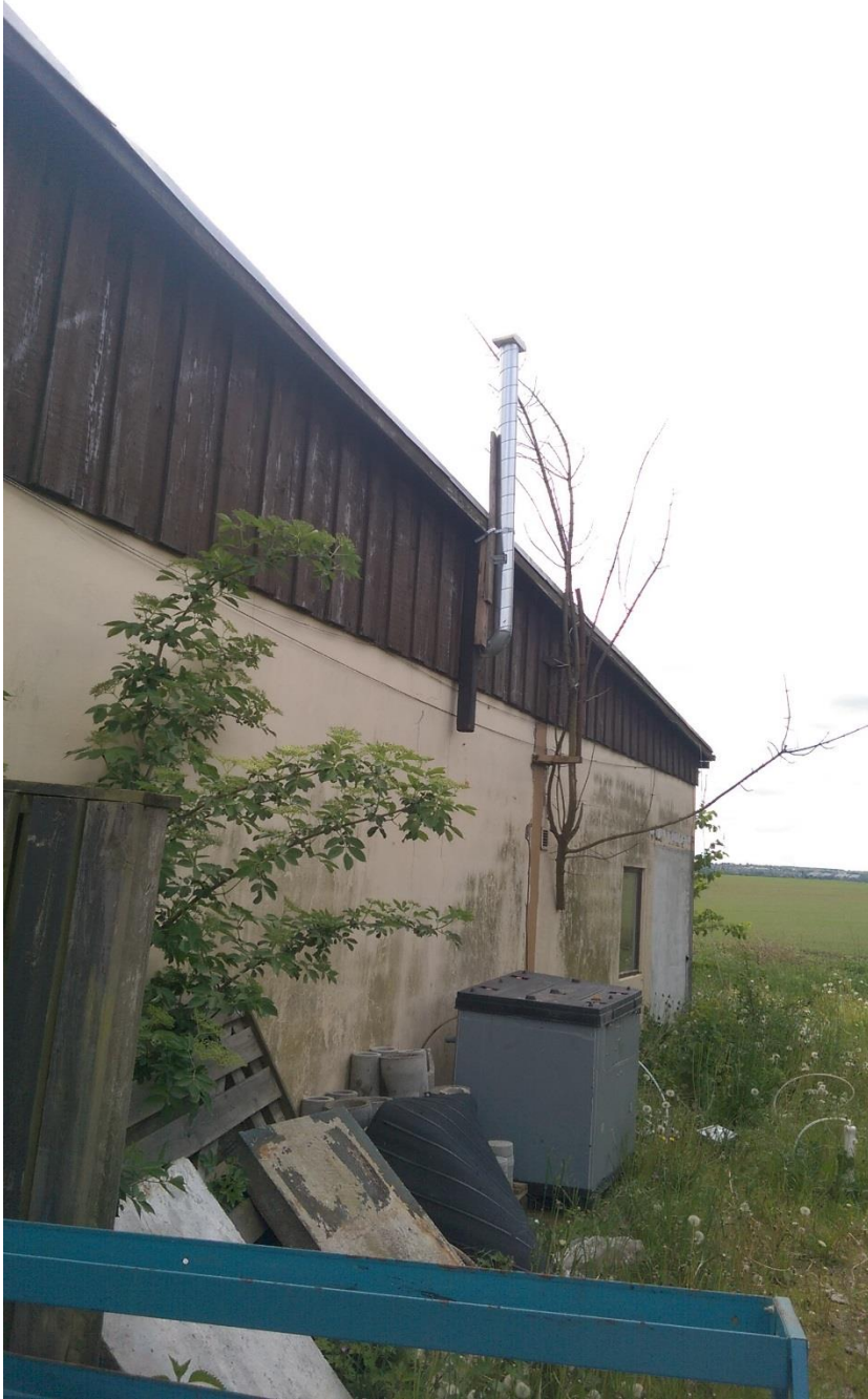
Afkast fra punktudsugning er ført op over tag.
