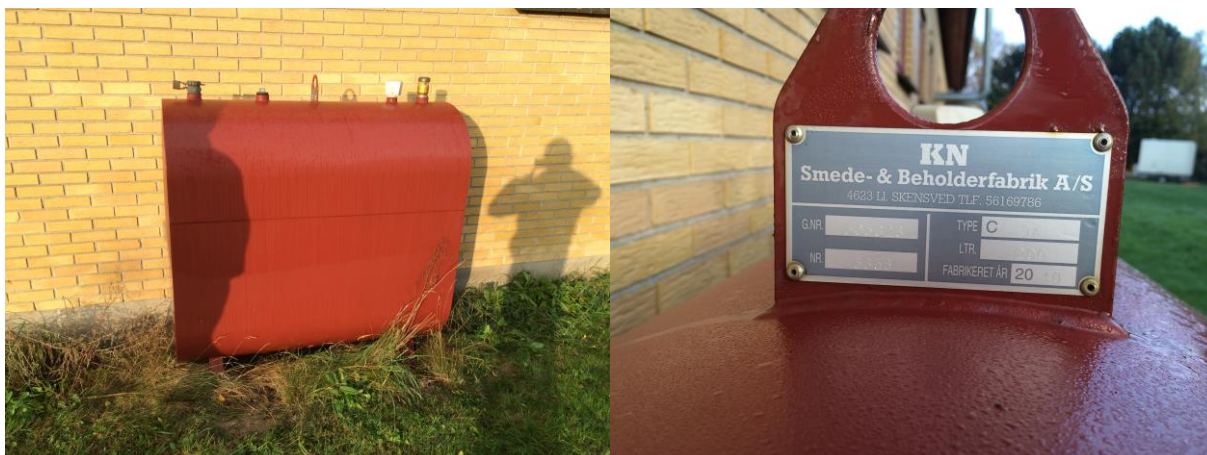
Overjordisk olietank til fyringsolie (billede fra tilsyn 2016).
