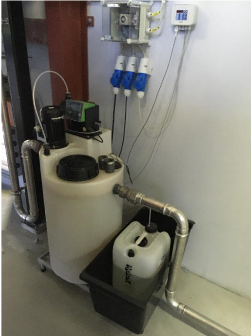
Neutraliseringsanlæg med lud.
