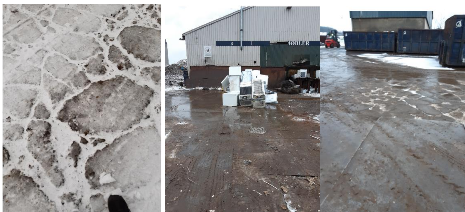
Eksempler på belægningens stand ved hhv. metalgården og køleskabs-shredder-området for aflæsning.
