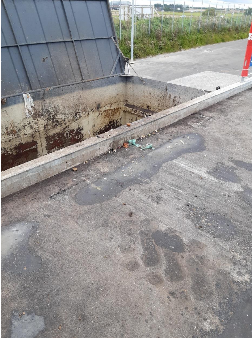
Foto 6. Rampe ved container til omlastning af kildesorteret madaffald. Container er åben for besigtigelse.
