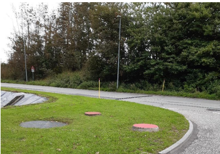
Foto 2. Afspærringsventiler til opsamlingsbassin er markeret med rød maling
