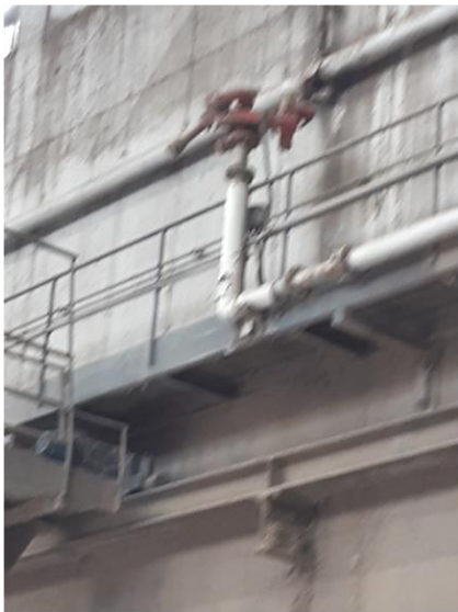
Foto 7. Brandslukningskanon i affaldssiloen. Kanonen er fjernstyret og kan skyde rent vand eller brandslukningsskum
