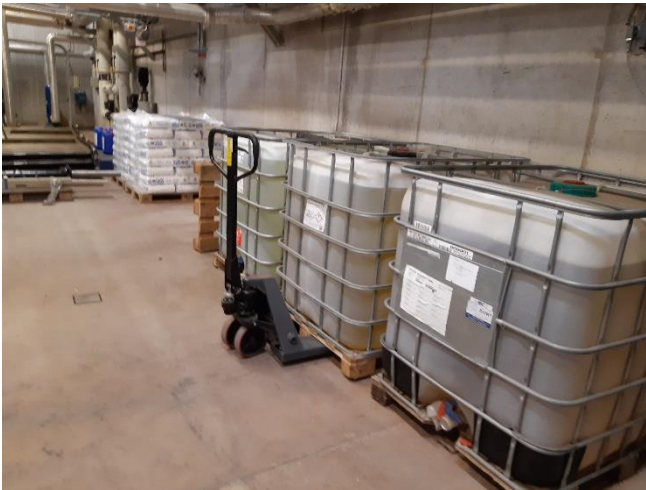
Foto 2: Opbevaring af kemikalier i palletanke. På fotoet ses også gulv afløb.
