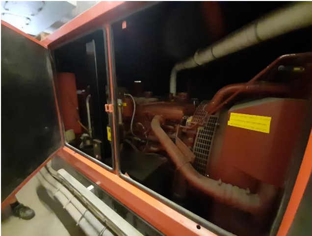
Foto 6: Dieseldrevet nødstrømsanlæg med egen olietank.
