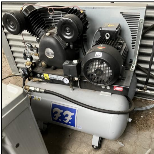
Kompressor udendørs i åbent skur
