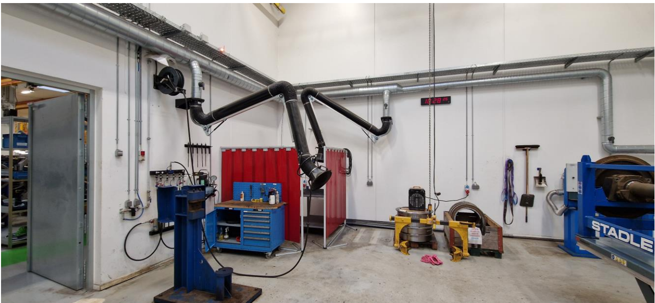
Maskinværkstedets punktudsugning til svejsning m.m.
