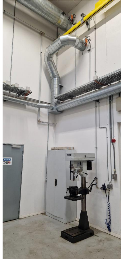
Maskinværkstedets samlede afkast ledes ud gennem væg og op over tag til fri fortynding.
