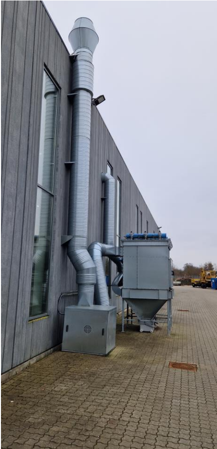
Luftafkast fra fræsning af toghjul. Udsuget luft renses i posefilteranlæg.
