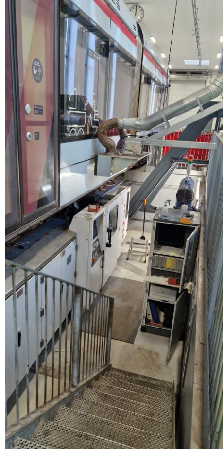
Udsugning ved fræsemaskine til toghjul.
