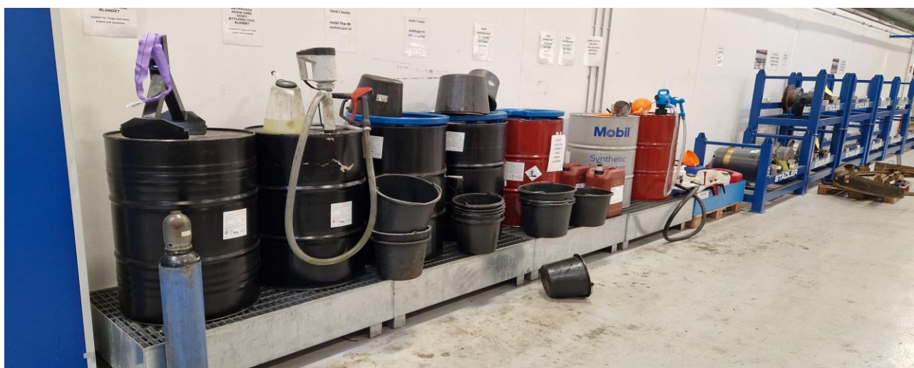
Olieprodukter med spildsikring.
