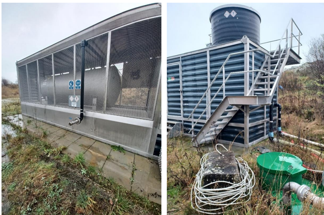
Figur 3. Perkolatforbehandlingsanlæg. Anlægget består af en perkolatbehandlingstank (til højre) og en kemikalietank med hydrogenperoxid. Hydrogenperoxid tilsættes fra kemikalietanken via kemikaliedoseringsanlægget til behandlingstanken, hvor perkolatet iltes under omrøring.
