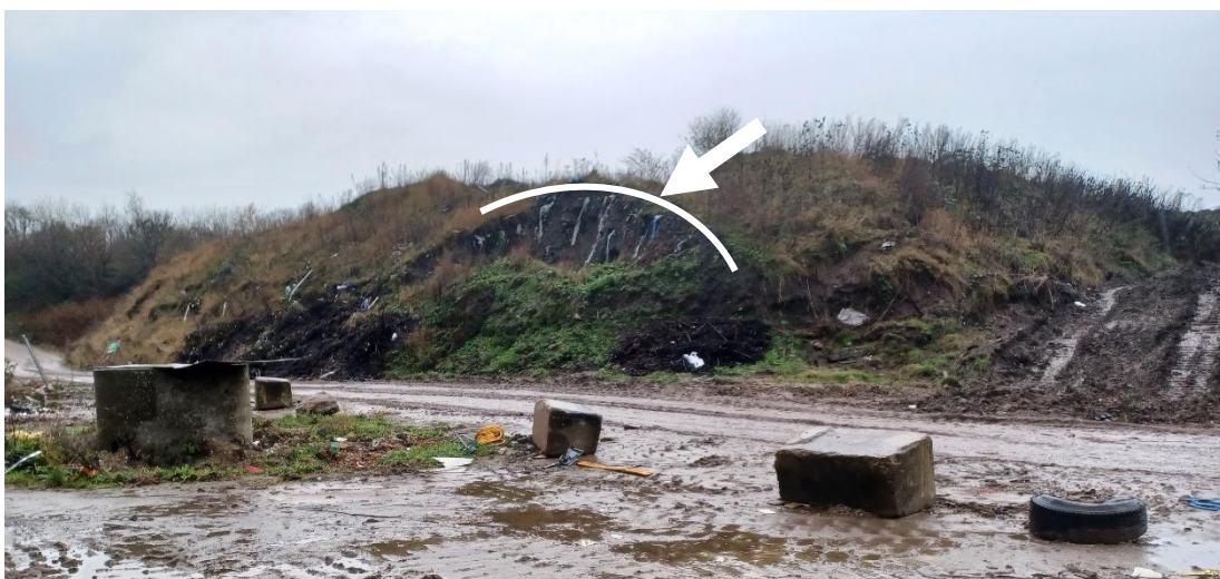
Figur 1. Etape 6 og etape 5. Øverst: Big-bags med PCB affald på etape 6. Midt: Afdækning af asbestaffald på etape 6 med affaldstræ. Nederst: Synligt affald langs siden af etape 5.
