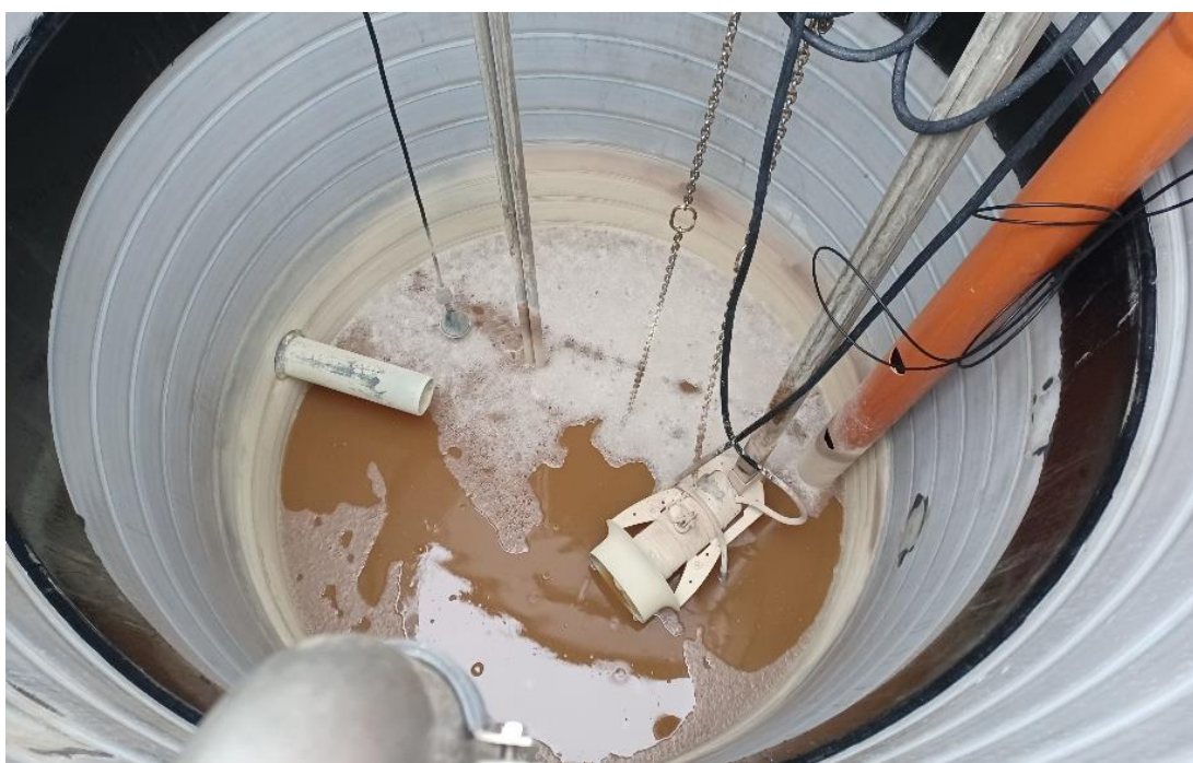
Figur 4. Perkolatforbehandlingsanlæg. Øverst: Perkolatledninger på jorden ved siden af behandlingstanken. Nederst: Kig ned i behandlingstank. Trykmåler er installeret i det orange rør.
