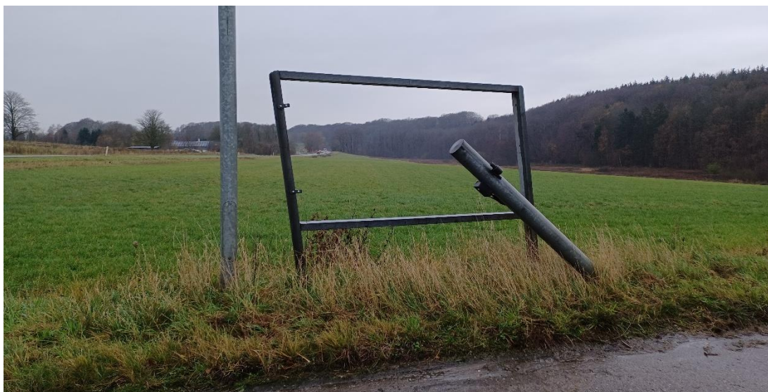
Figur 11. Manglende skiltning ved indkørsel til deponeringsanlægget.
