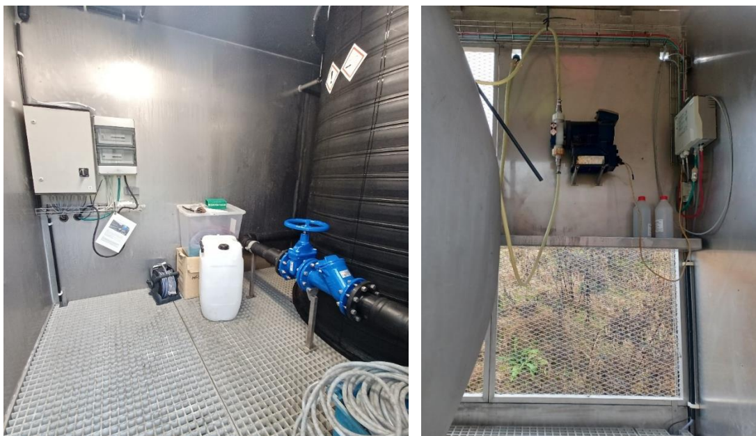
Figur 5. Perkolatforbehandlingsanlæg. Tv: Procedure for anlægget hænger ved instrumenterne inde i containeren med behandlingstank. Th: Kemikaliedoseringsanlæg ved siden af kemikalietank.
