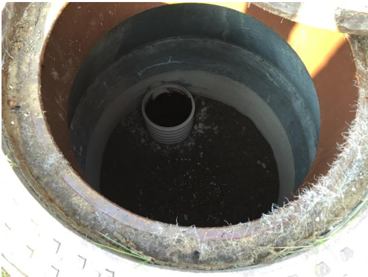
Billede 4 – prøvetagningsbrønd efter nedsivningsgrøft
