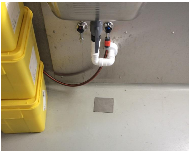
Billede 2 – Afløb lukket af med metalplade
