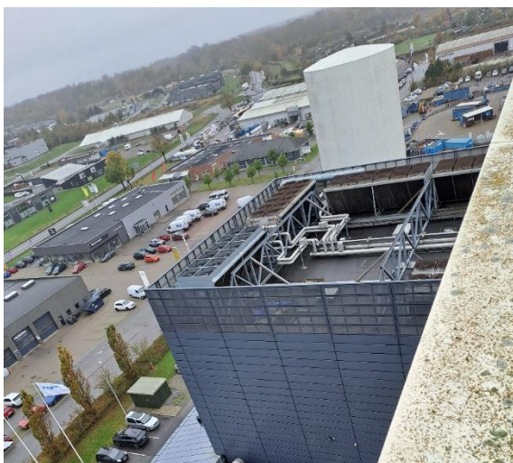
4 af de 8 kølere på taget af bygningen
