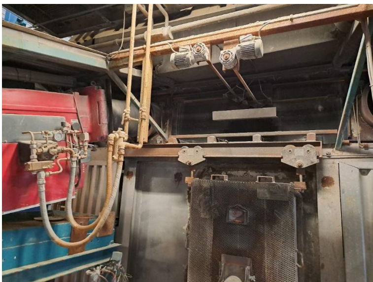
Opstartsbrænder og indgangen til ovnrummet i ovn 3
