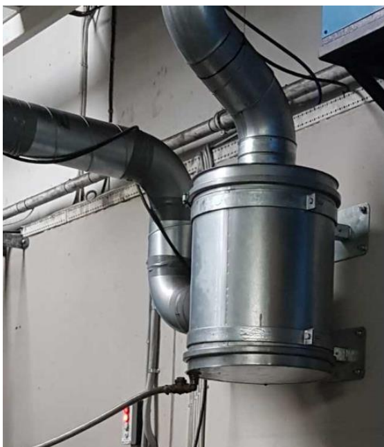
Olietågefilter / dråbefang er placeret ved de enkelte spåntagende maskiner.
