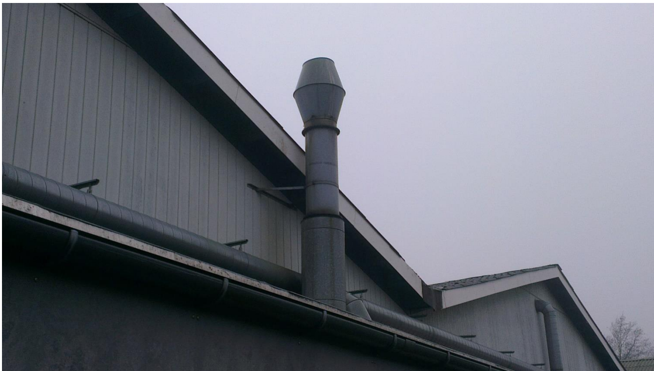
Udsugningsafkast fra spåntagende maskiner.
