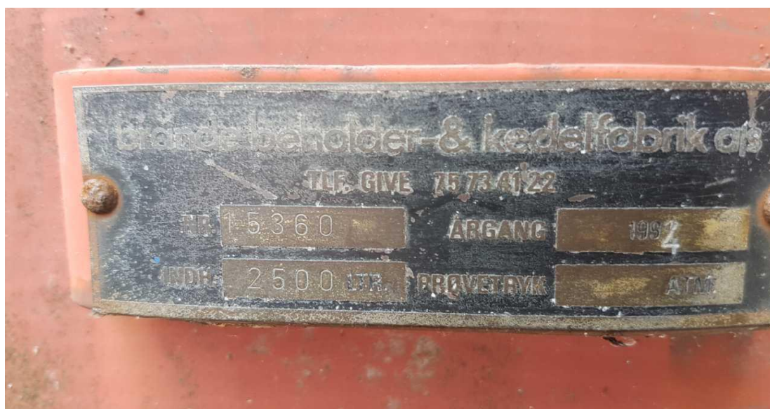
Tankplade på olietank.
