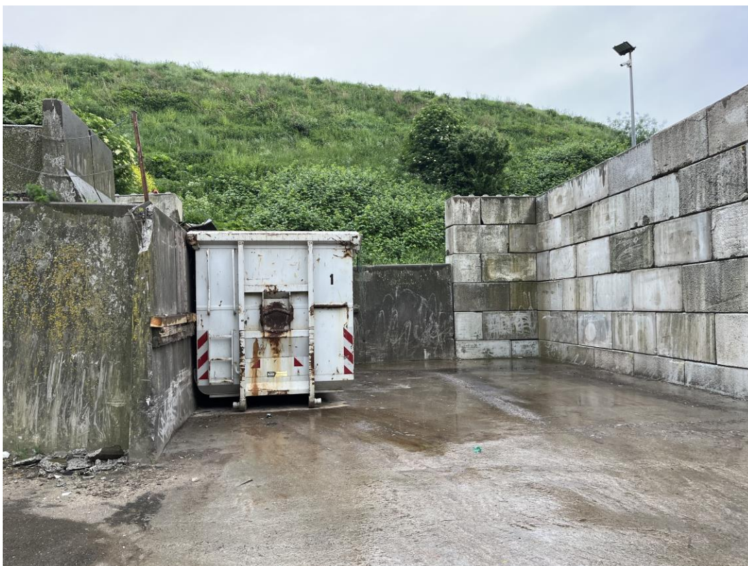
Figur 16 Faciliteter til omlastning af dagrenovation, som ved tilsynet ikke var i brug.
