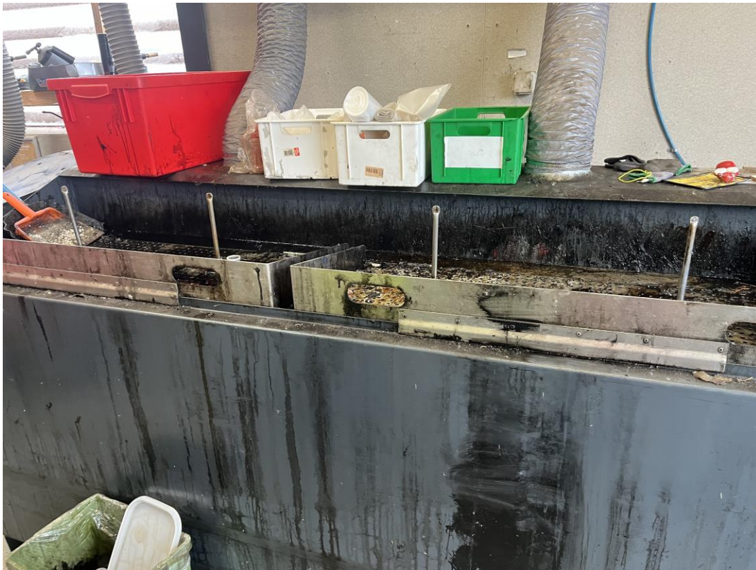
Figur 21 Tank til spildolie, er placeret indendørs i hal til farligt affald. Tanken står i opsamlingskar.
