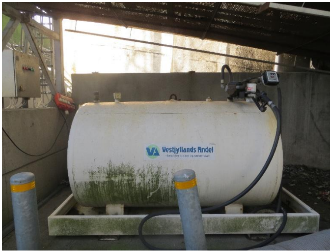
Dagtank til egne maskiner.
