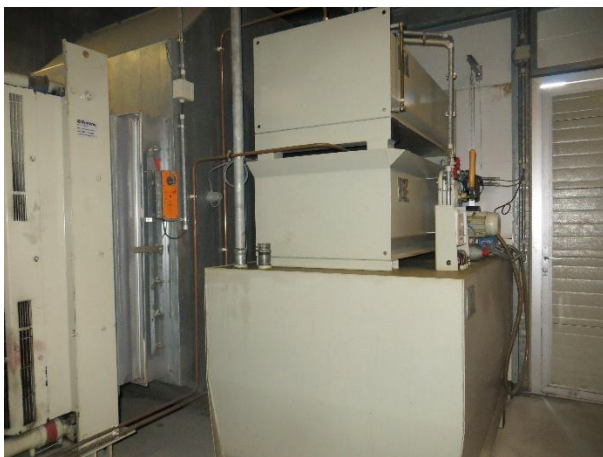
Olietank ved eksisterende nødstrømsanlæg.
