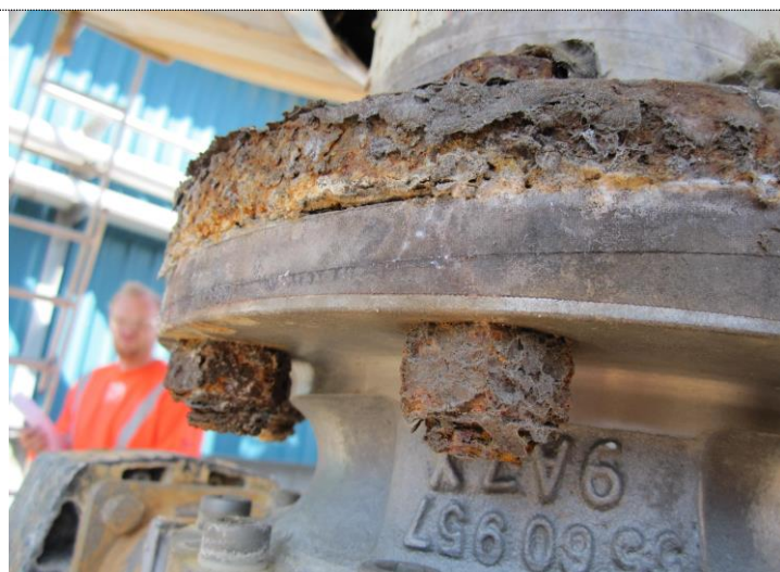
7. Korroderede bolte ved ventil i bunden af keglen bør udskiftes.
