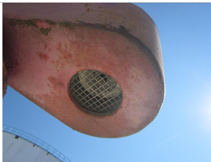
16. Nettet på vakuumsiden af P/V ventil.
