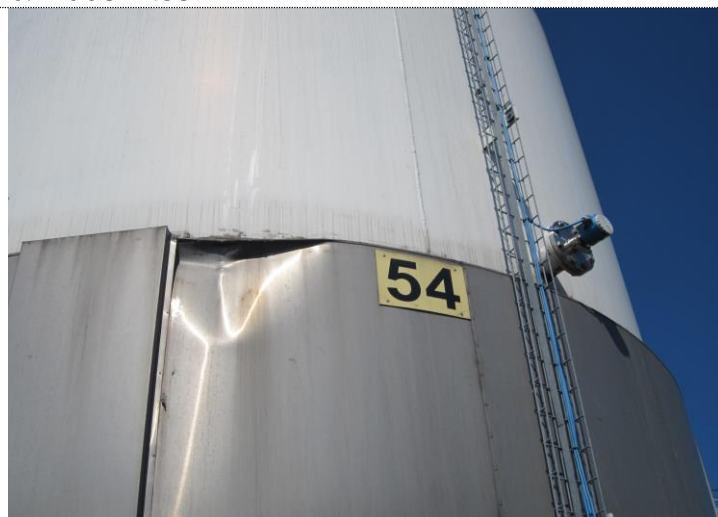
9. Skade på isoleringskappe bør udbedres.
