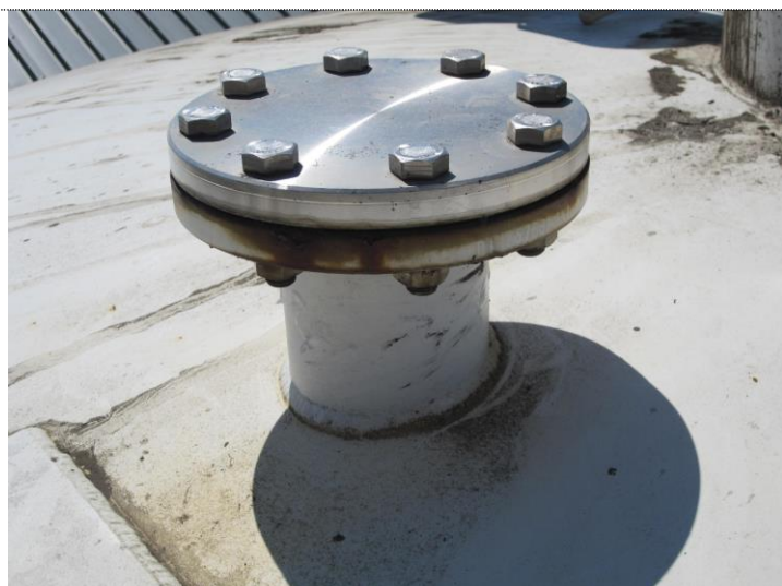
15. Eks på rustgennemslag i flange på studs på taget.
