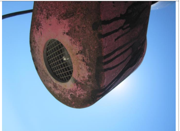
16. Nettet på vakuumsiden af P/V ventil.
