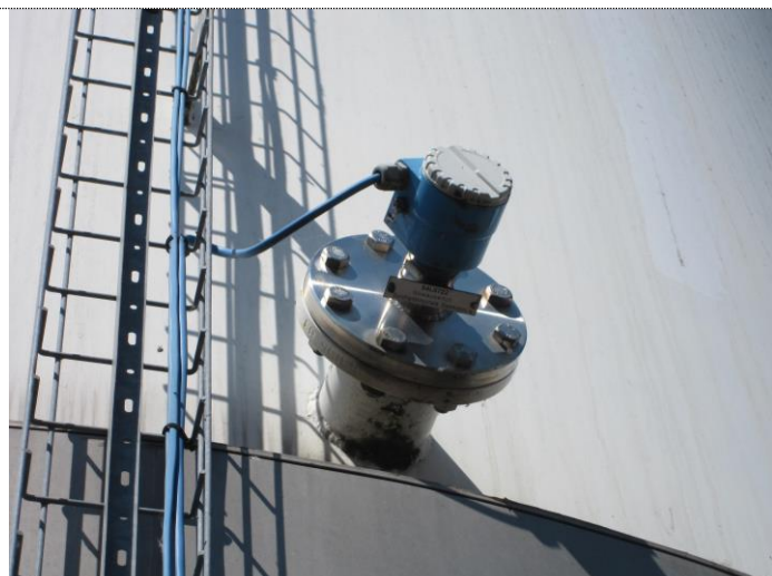
10. Studs nr. 2 i svøb, Niveauføler.
