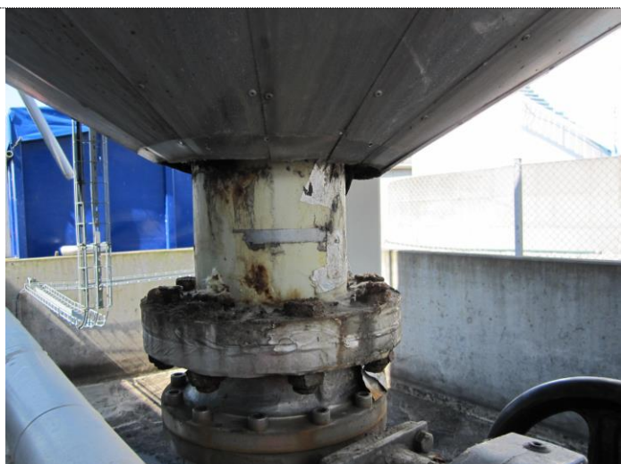
6. Studs i bunden af keglen, der ses begyndende rustgennemslag, dette bør afenses og males.
