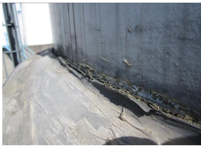
12. Sealingen mellem isolering og svøb har sluppet vedhæftning flere steder. Dette bør udbedres så man undgår vandindtrængen.
