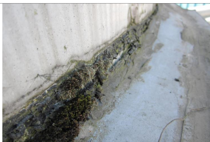
5. Defekt sealing mellem isoleringskappe og svøb.
