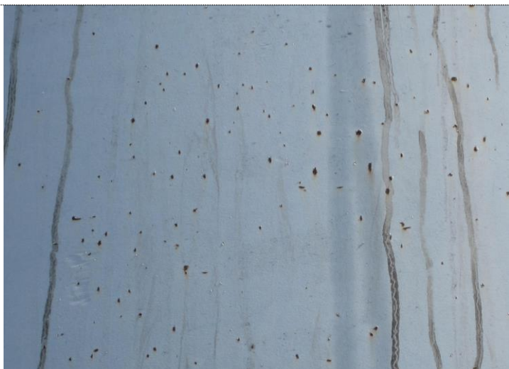
9. Der ses begyndende rustgennemslag flere steder på svøbet.
