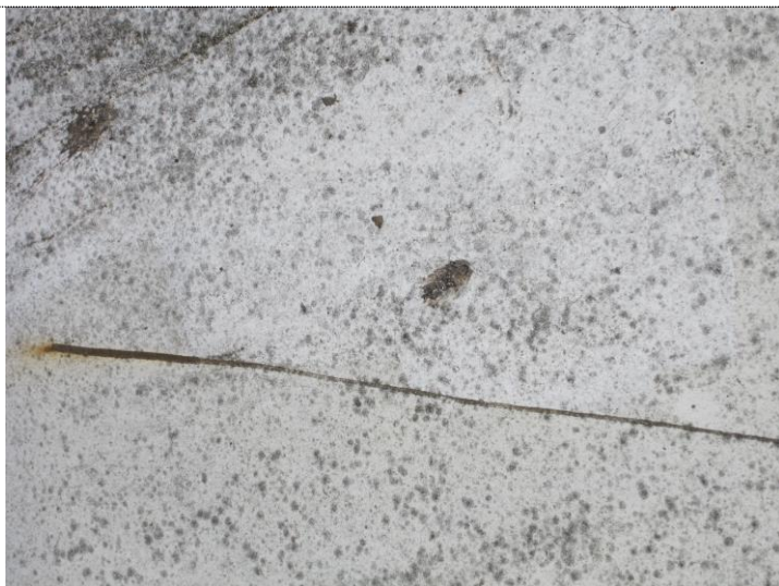
13. Eks på skade på malingen på taget. Dette bør afrensnes og males.
