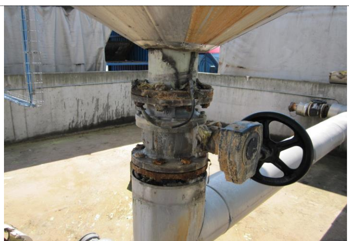
6. Studs i bunden af keglen, der ses begyndende rustgennemslag, dette bør afenses og males.
