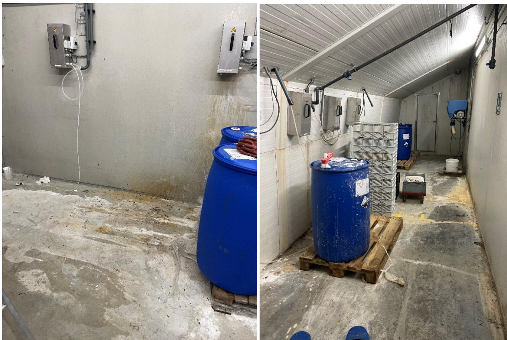
Tønder med syre og lud opbevares nu i separate rum på fast gulv uden afløb
