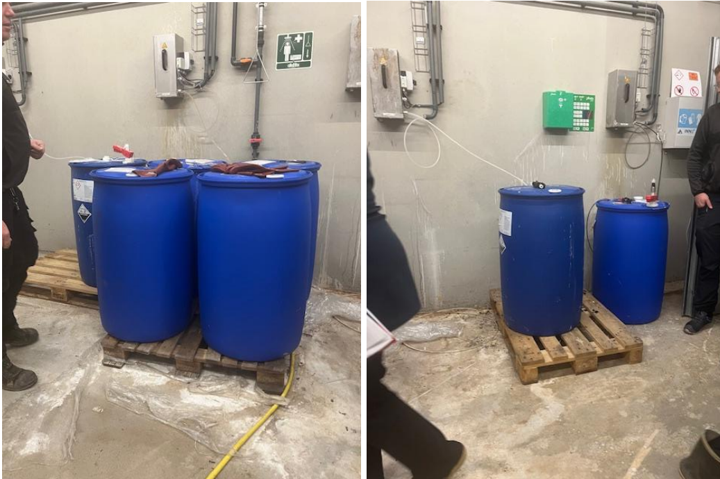
Tønder med syre og lud, begge opbevaret i teknikrummet
