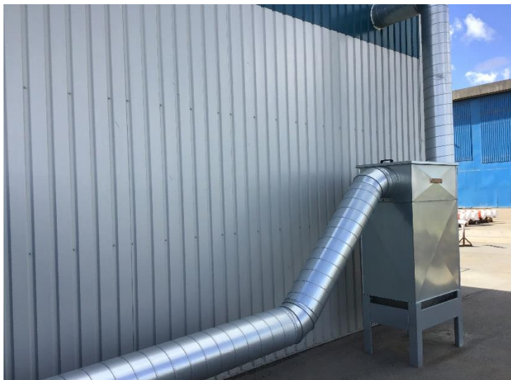
Filteranlæg hørende til bejdseaktivitet.
