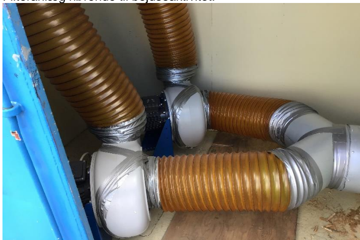
Ventilatorer hørende til filteranlæg (bejdseaktivitet).
