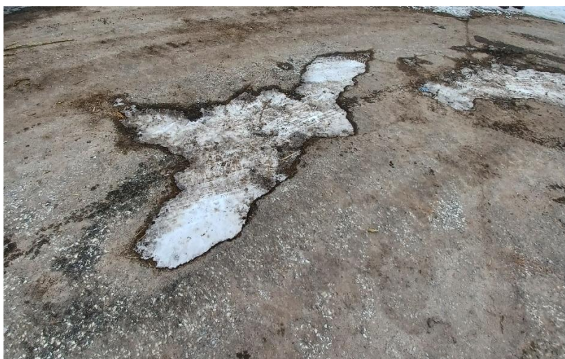
Fotosamling 7. Belægningens tilstand ved haveaffaldspladsen.
