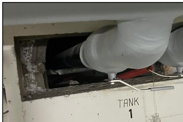
Rør til fyringsolie, der kommer ud under loftet i kælderen
