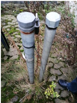
Billede 1 Påfyldningsstuds og udluftningsrør på nedgravet olietank under 6000 L
