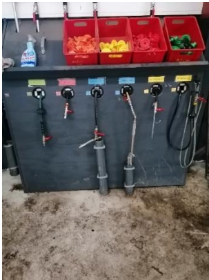
Billede 1. Miljøbehandlingsanlæg i værksted.
