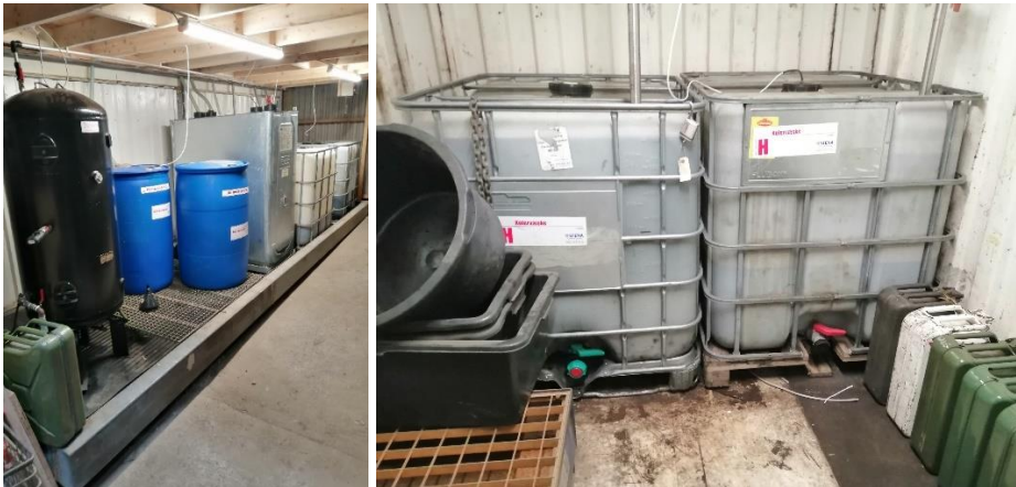
Billede 4. Oplag af benzin (sort rund metal tanknr. 4), bremsevæske (to blå plast spændefade), Diesel (dobbeltvægget 1.000 L metal tanknr.3 fra Roth), olie (1000 L plastpalletank), Kølervæske (1.000 L plast palletank) på spildbakke.
