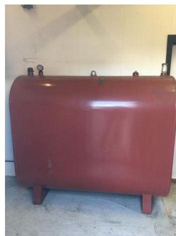
Olietank fra 2018 (billede fra tilsyn i 2021)
