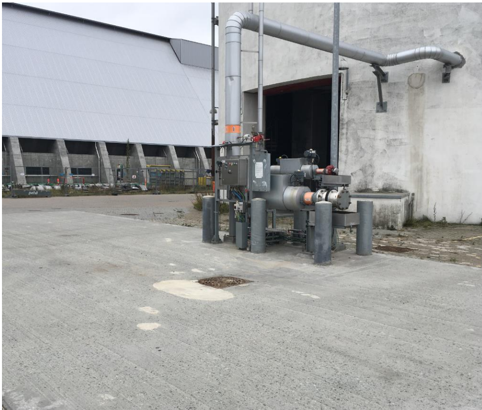
Foto 4 Pumpeanlæg til let olie. Silo til kulflyveaske til højre
