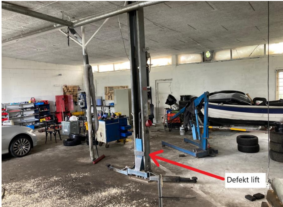
Billede af værksted samt defekt lift.
