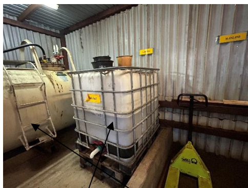
Figur 3: Oplagsplads til tank med ren ammoniak og palletank til \text{NH}_3 -vand (ammoniakvand) (2025)
