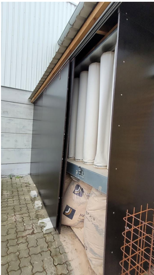
Nyt posefilteranlæg til udsugning fra det nye træværksted.
