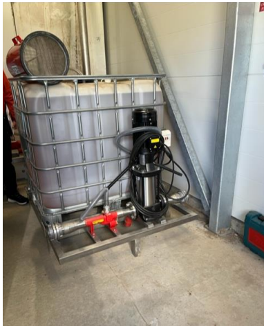
Foto 3: Mobil pallettank med brandslukningsskum
