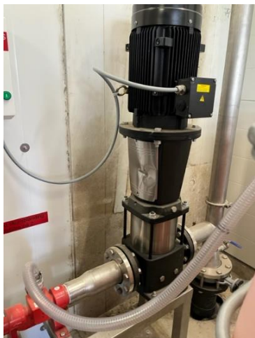
Foto 5: Pumpe til mobil pallettank. Bemærk gennemboring af betongulv.
