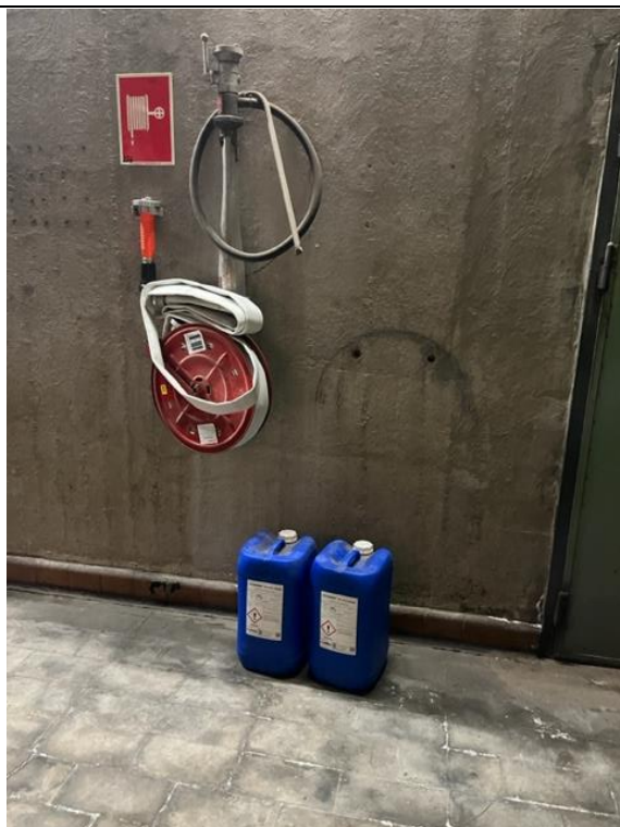
Skumslukningsanlæg i blok 1
