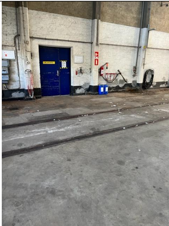
Skumdunkene i hallen overfor olierummet er placeret tæt på afløb.
