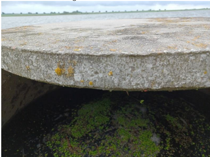
Udløbsbrønd næsten fuld, da udløsningsrør fra brønden ikke spulet tomme siden 2019 og udløsningsrør fra brønden derfor ikke kan følge med tilførsel fra bassin 3
