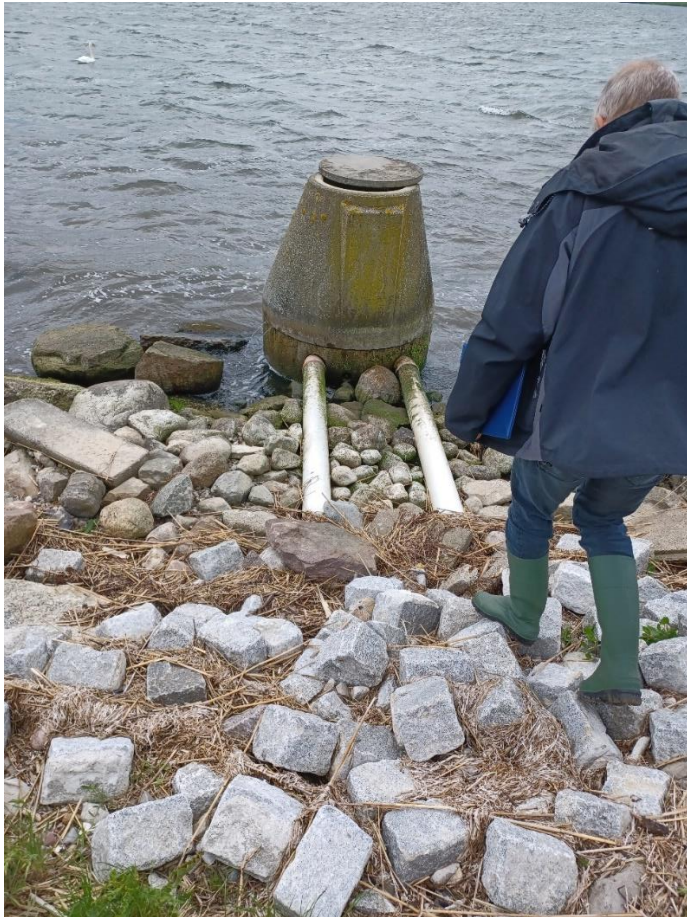
De to rør fra bassin 3 til udløbsbrønd
