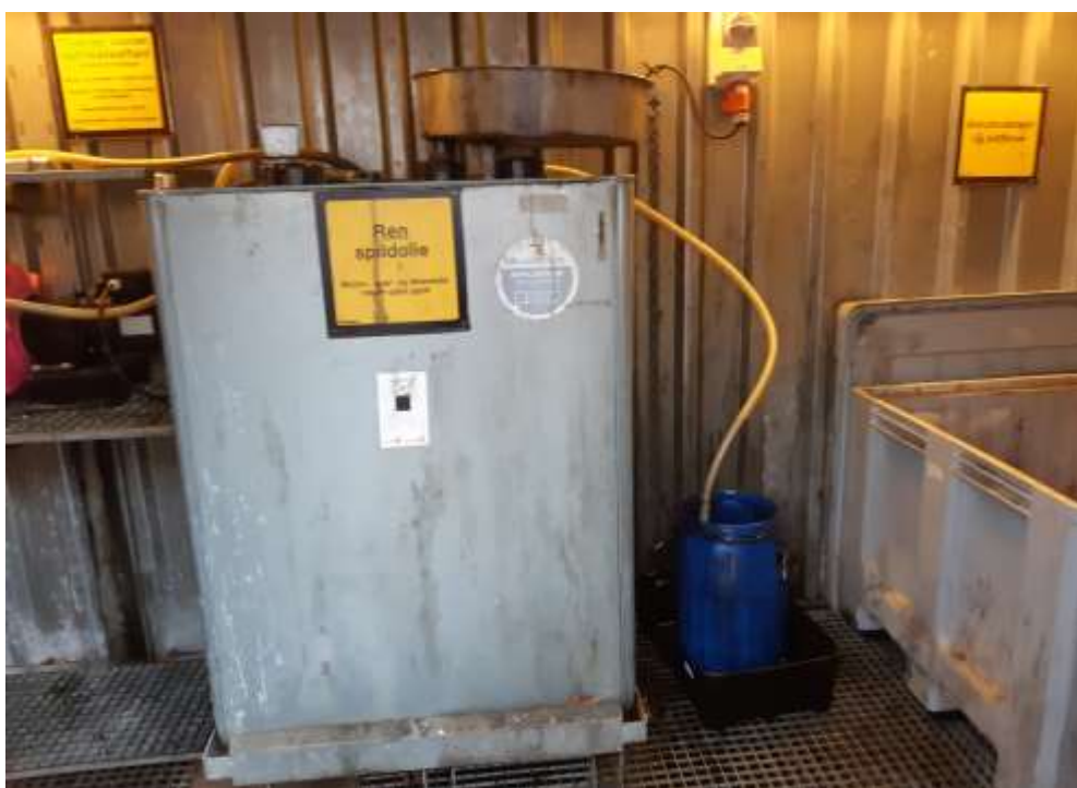
Containerskur til farligt affald. Til venstre: hylder hvor beholdere med brugt kemi kan stilles. I midten: spildolietank. Til højre palle-kar til brugte batterier. I gulvet ses spildbakke.
