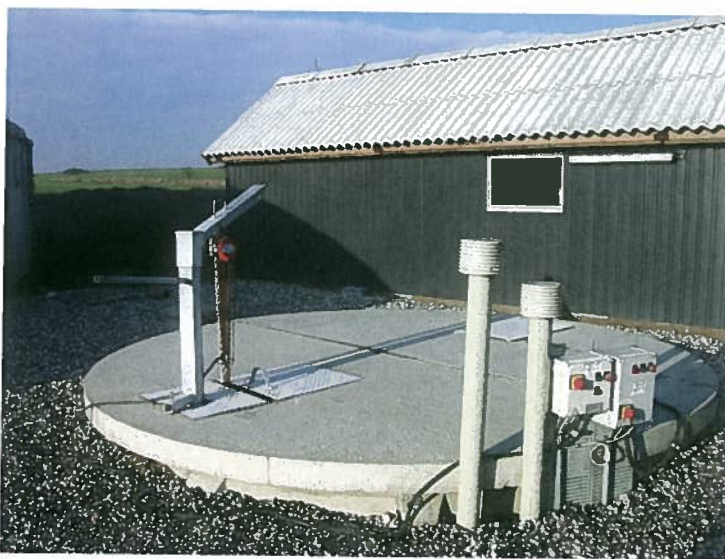
Figur 1. Bygning hvor separator er installeret og fortank hvorfra rågyllen suges til separatoren.
