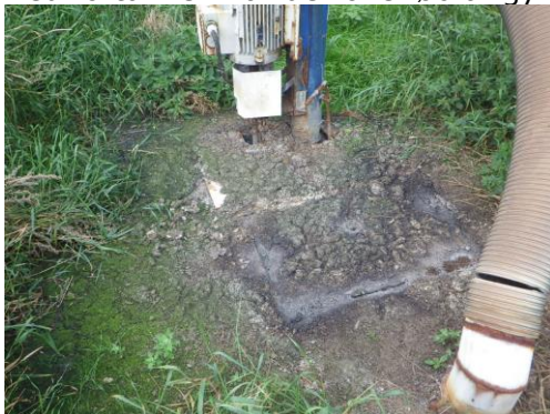
Billede 1: Overløb af gylle ved gyllepumpen.
