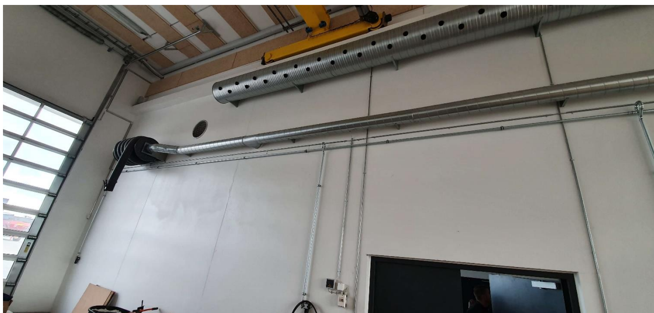
Udsugning med slangerulle til udstødningsgas.
