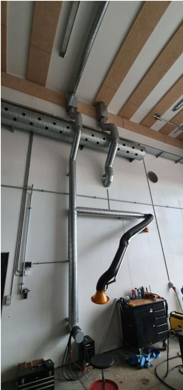
Punktudsugning og udsugning til udstødningsgas er ført op til over tag.
