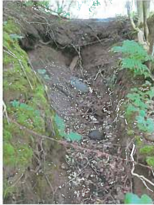
Skrænten er udhulet pga. afstrømning
