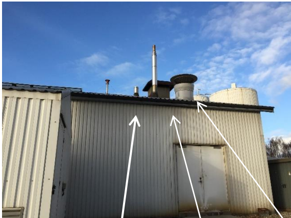
Billede nr. 8: Sikkerhedsventil, afkast gaskedel, afkast gasmotor (2018).
