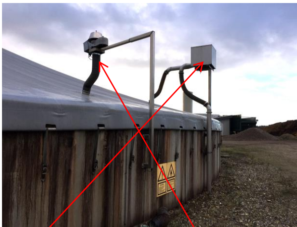
Billede nr. 6: Måler til registrering af trykket, samt pumpe til biogassen (2018).
