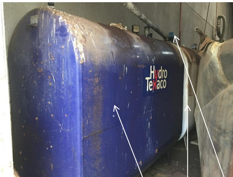
Billede nr. 9: Olietanke til opbevaring af spildolie og fyringsolie, niveualarm (2018)
