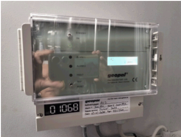
Ammoniak detektor i opsamlingsbrønd for kondensat fra fordampere.
