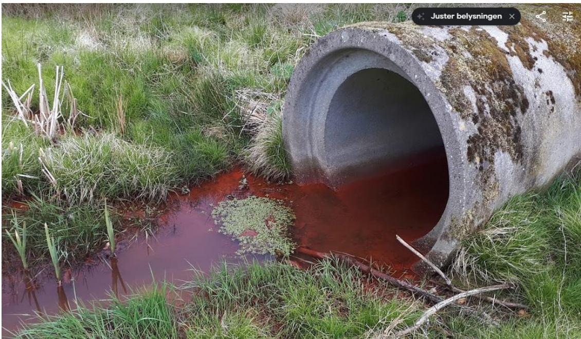
Figur 12. Udløb fra Betongruppen i Roust onsdag kl. 11.00.
