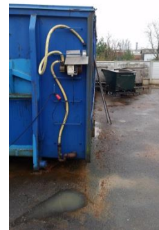
Overdækket, dobbeltbundet container på befæstet areal til spåner med køle/smøremidler
