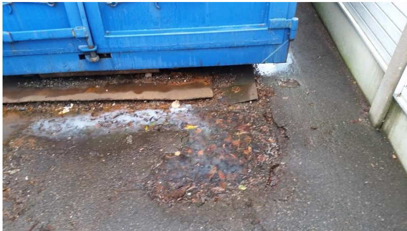
Foto fra tilsyn i år 2015 med spildt væske på slidt asfaltbelægning ved siden af container til opbevaring af spåner
