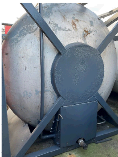
Ny spildolietank, der skal dokumenteres yderligere.
