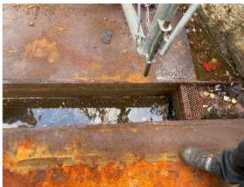
Afløbsrende, der stadig viser spor af oliespild
