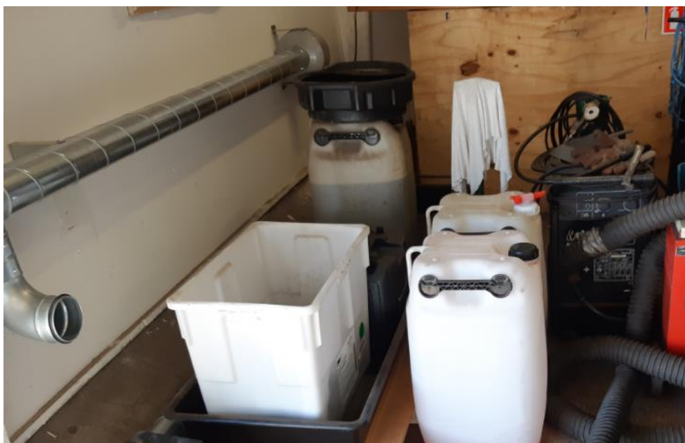
Spildolie m.m. på sorte plast-spilbakker. T.v. ses ny udsugning. T.h. ses slange til udstødningsgas
