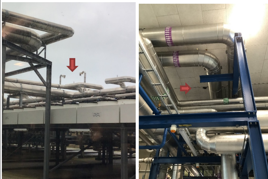
Ammoniak-sensorer i afkast og i loftet i driftsbygningen.
