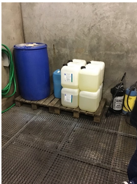
Oplag af kemikalier med afløb til olieudskiller. Spildbakke kræves.
