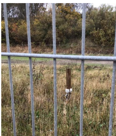
Opsamlingsbrønd (med ammoniak-sensor) for kondensat fra fordampere placeret i kølegården.
