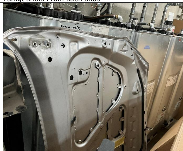
Spildolietank i kælder uden afløb
