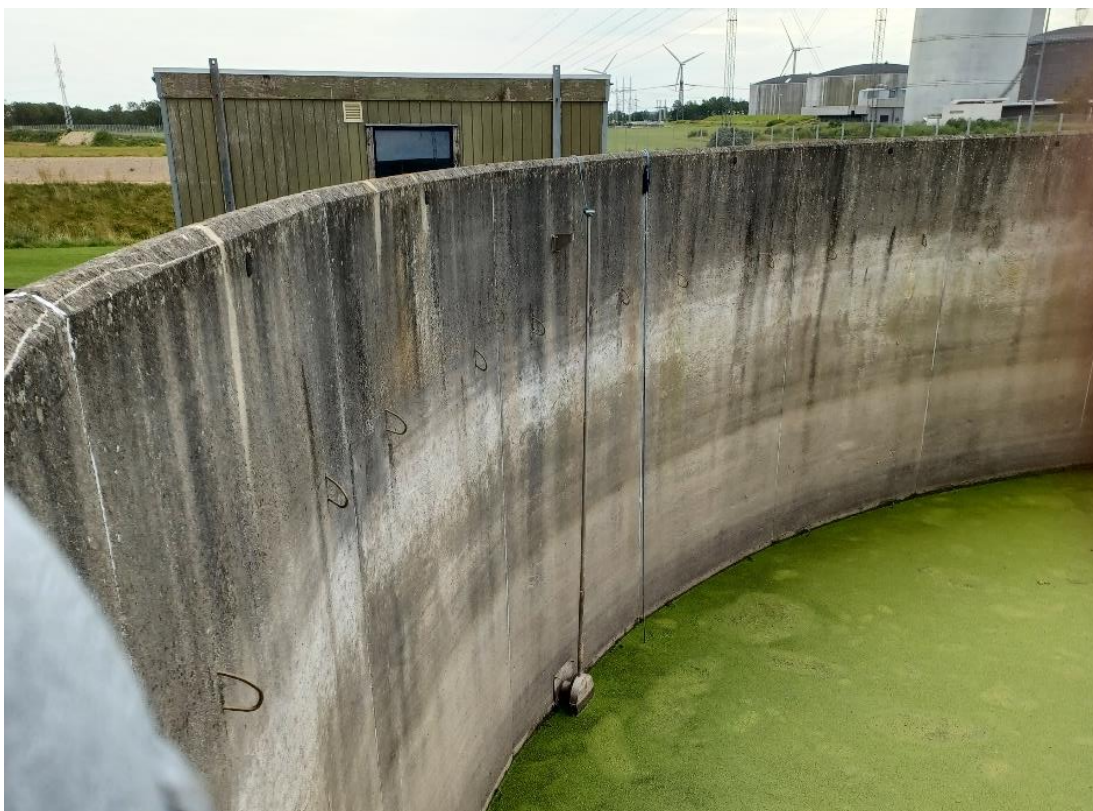
Figur 6. Spildevandsbeholder. Øverst: Spildevandsbeholder set fra pladsen. Nederst: Kig ned i tanken. Den blå ledning udgør tankens niveaumåler.
