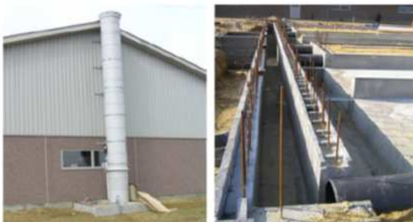
Figur 3. I drægtighedsstalden med læsgående søer, en ødeboks pr. sø er udsugningsanheden vedr. punktsugningen etableret for enden af stalden, hvilket giver mulighed for at tilkoble luftrensere. På billedet til højre ses tværkanalerne fra sektionen som forbindes med hovedkanalen, som ligger på tværs langs gavlens.
