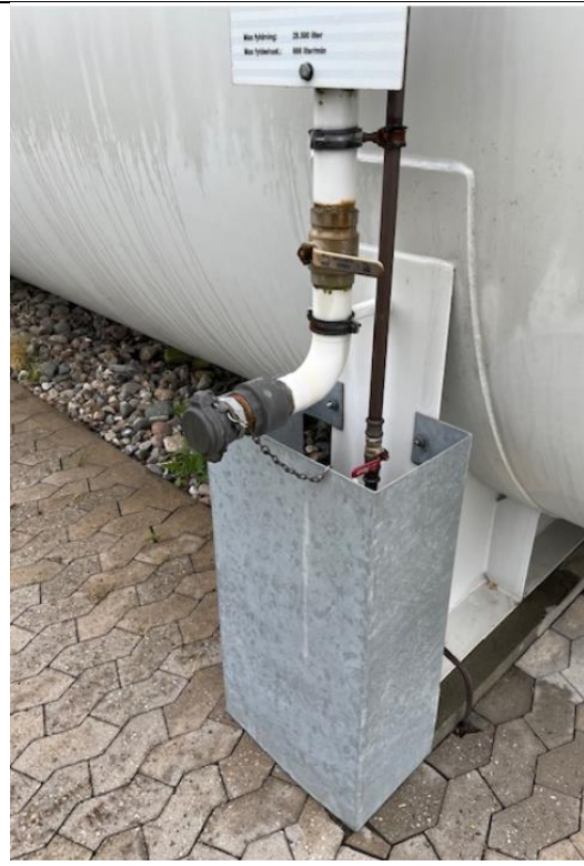
Belægning ved påfyldningsstuds
