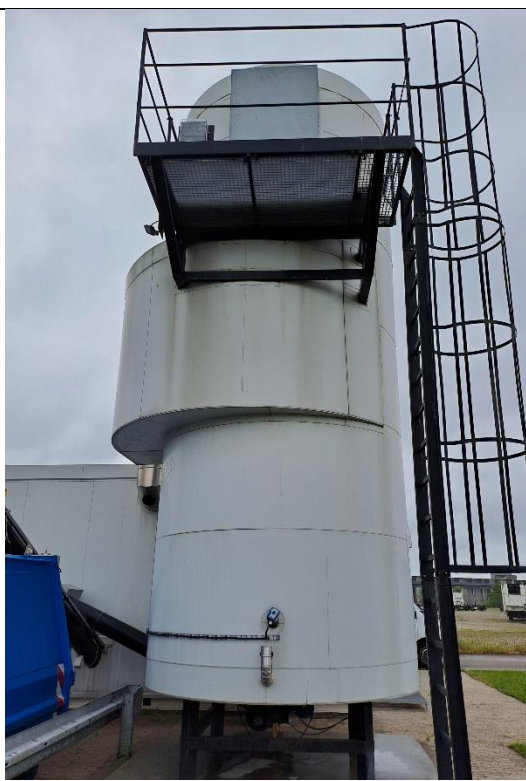
Silo til træpiller
