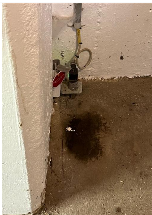
Gulvniveausensor i kælderen på pieren
