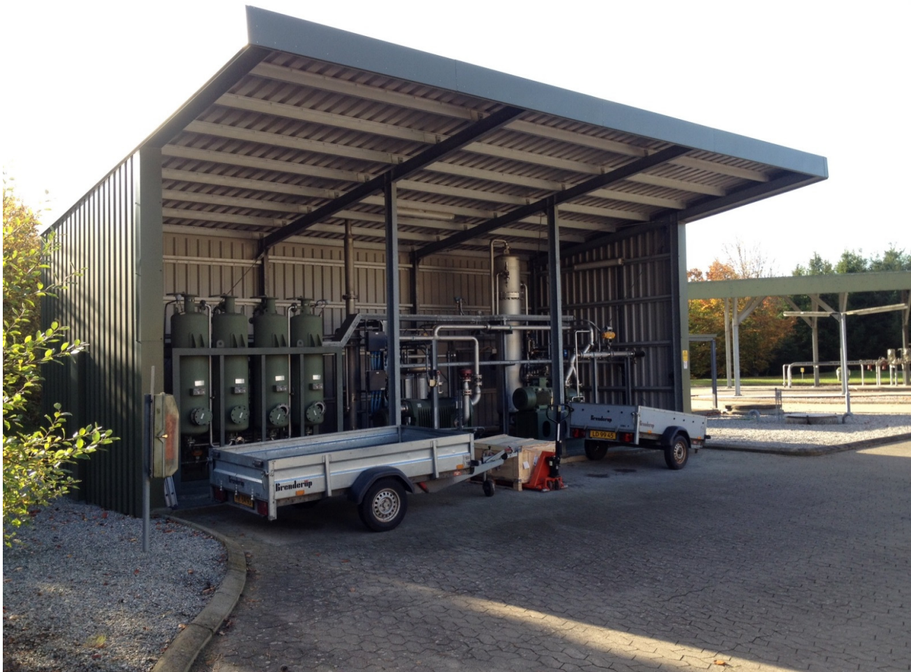
FIGUR 5 VRU-ANLÆGGET. ANLÆGGET ER INDFØRT I 2014 OG RENSER LUFT DER FORTRÆNGES FRA BENZINTANKENE
