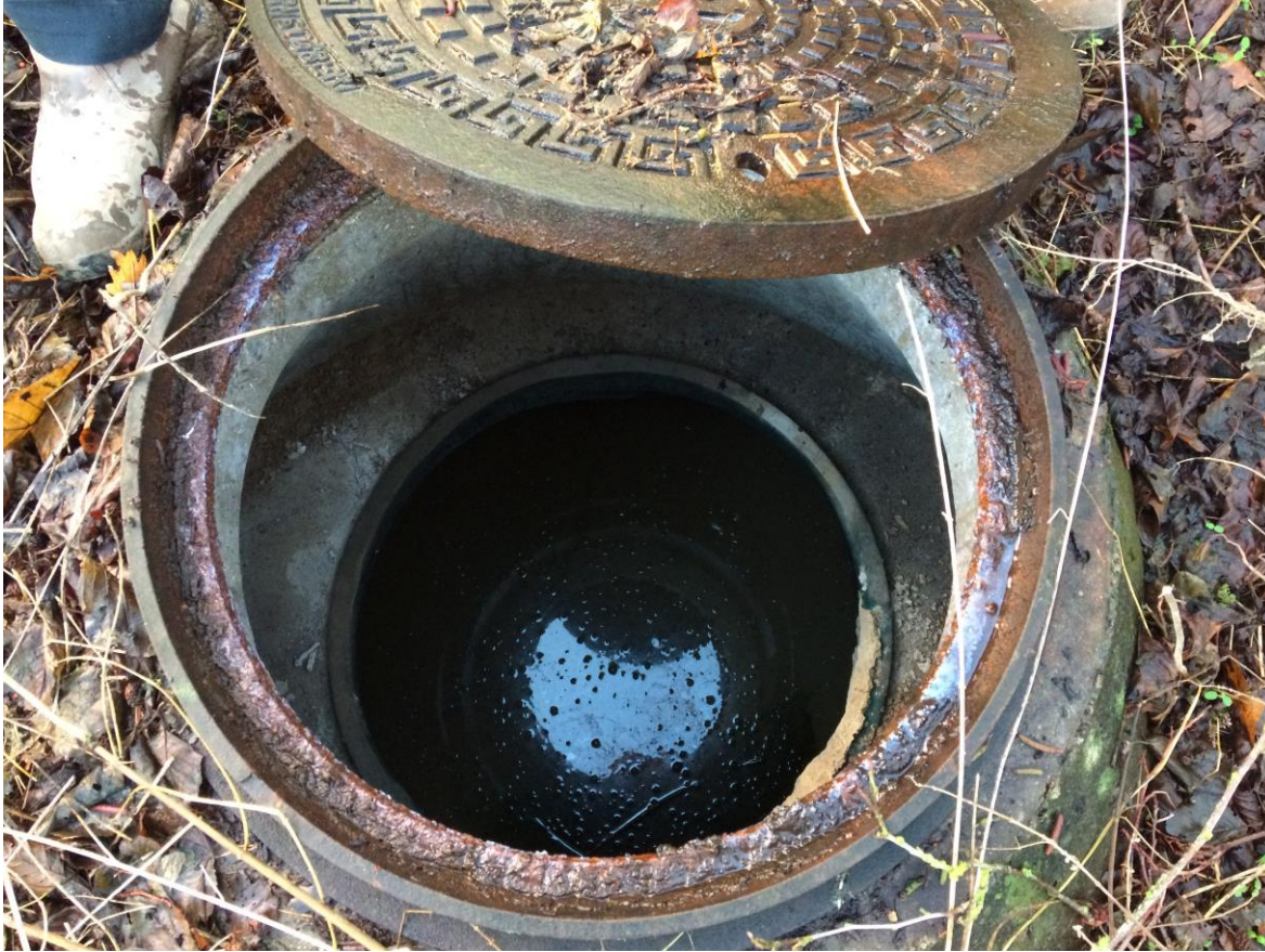
Billede 5d – Sandfang og fyldt brønd
