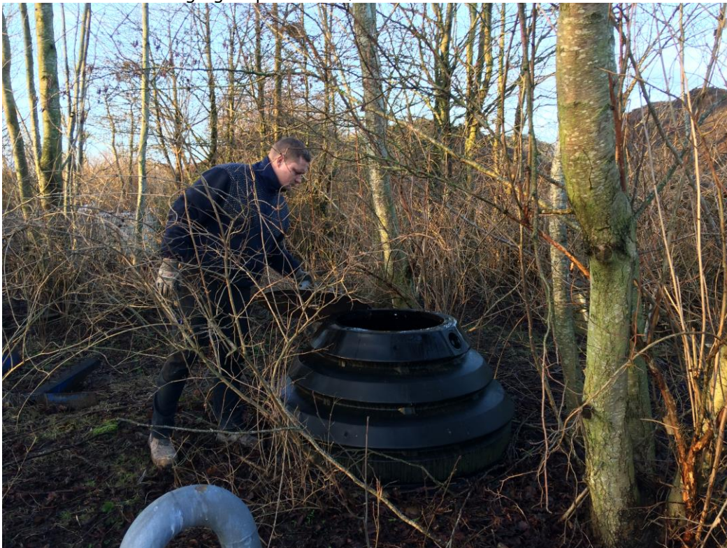
Billede 5a – Sandfang og inspektionsbrønd
