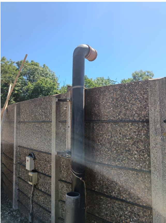
Figur 3 – Dykket indløb knækket på beholder fra 1992 (1980 m 3 ).
